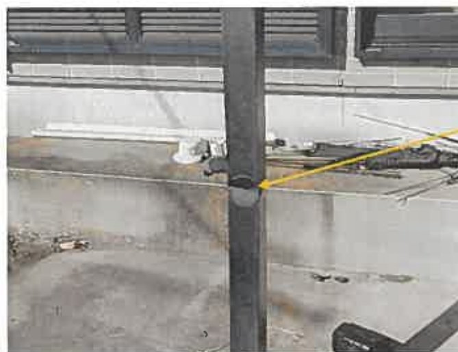
テラス支柱の損壊
