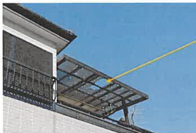
バルコニー底の 損壊
