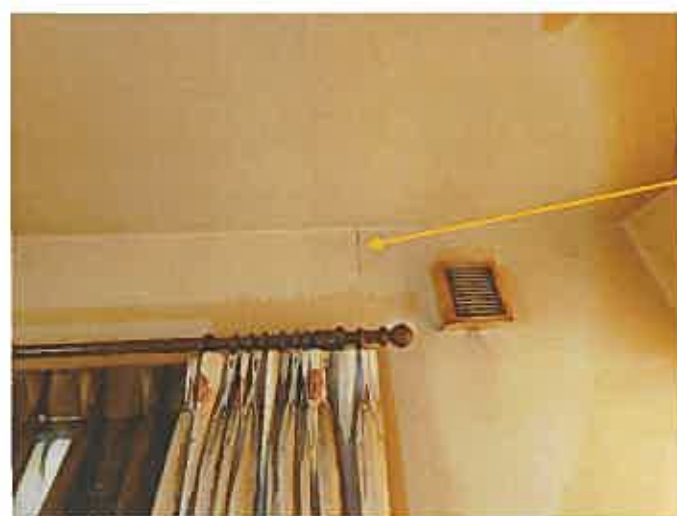
壁クロスの傷み
