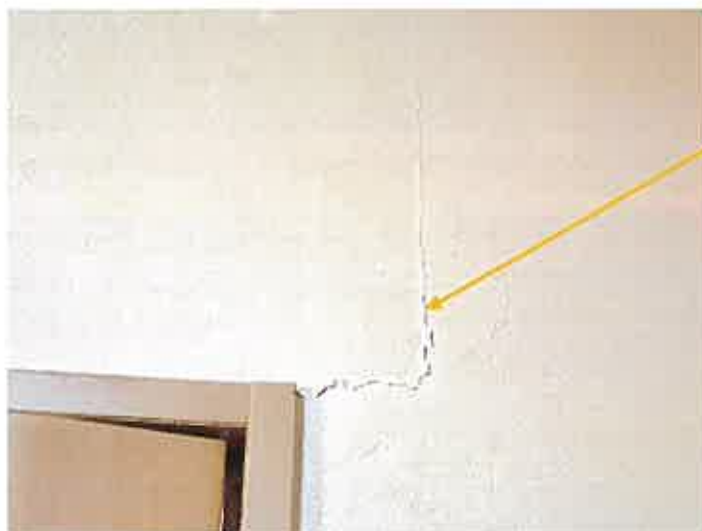
地震による 壁の亀裂
