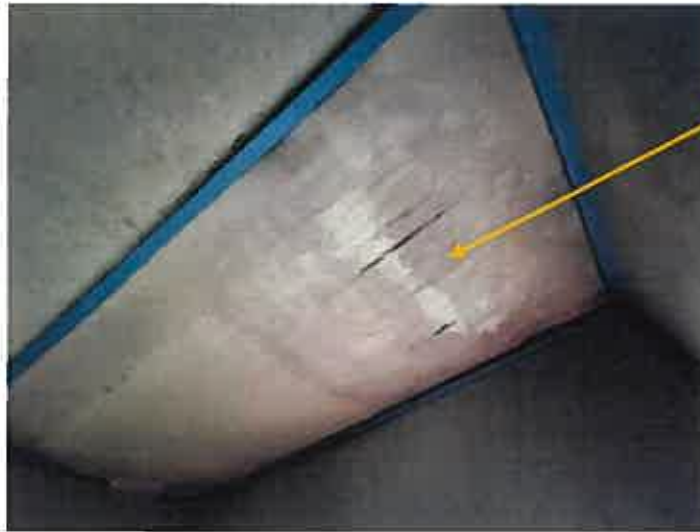
天井の雨漏り跡
