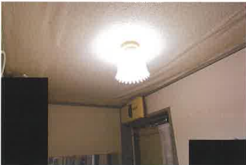
玄関ホール天井クロスの状態
