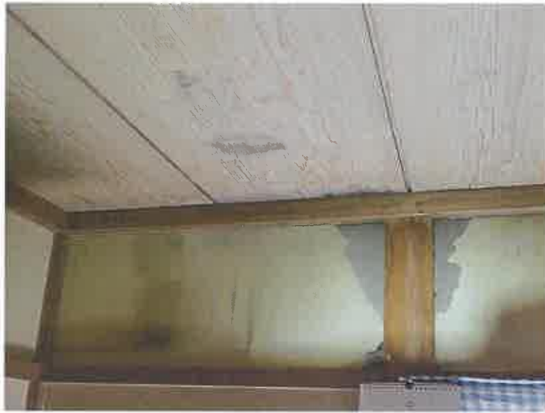
居宅部分の雨漏り跡 ⑬
