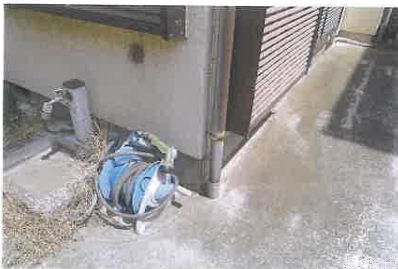
物件3の基礎のひび割れ
