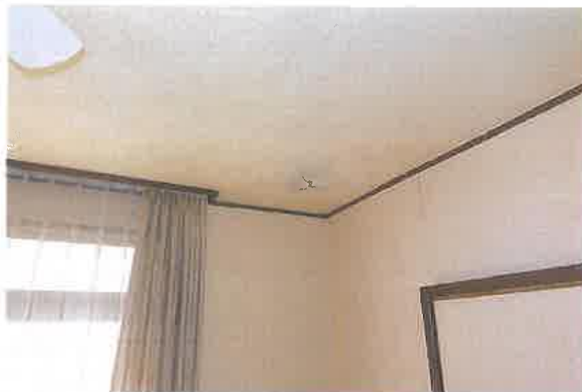
リビング天井の雨漏れ痕及び損傷
