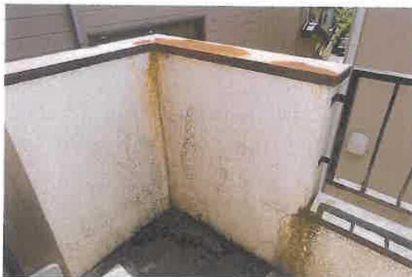
ベランダの錆び
