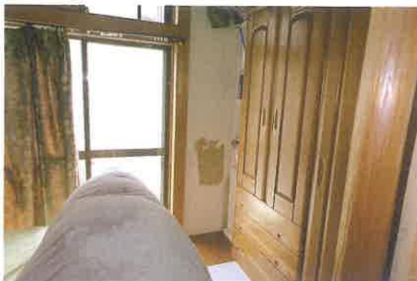
1階洋室①壁クロス剥がれ
