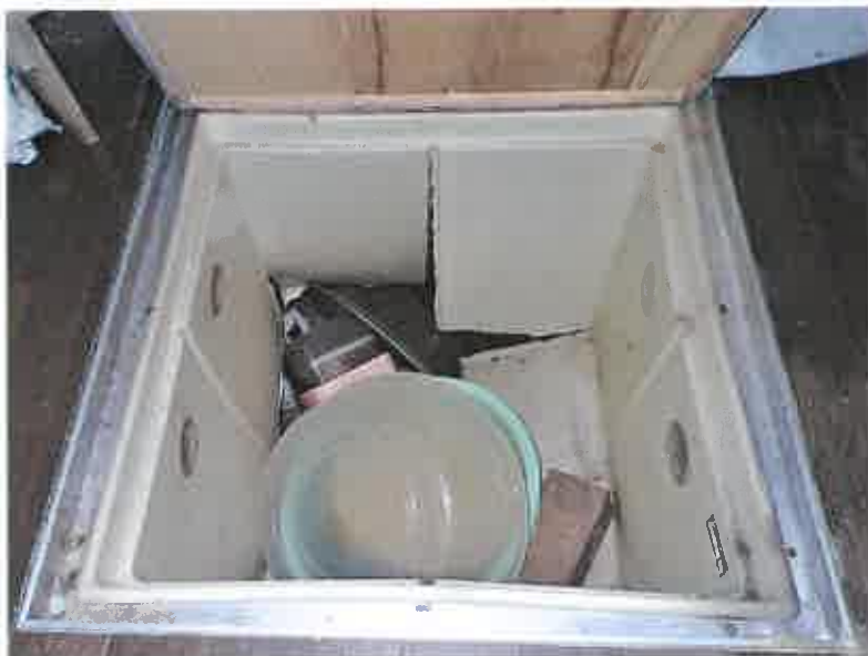
床下収納庫のプラスチックの破損 ⑦
