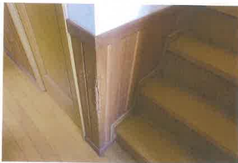
1階ホール壁の猫による損傷
