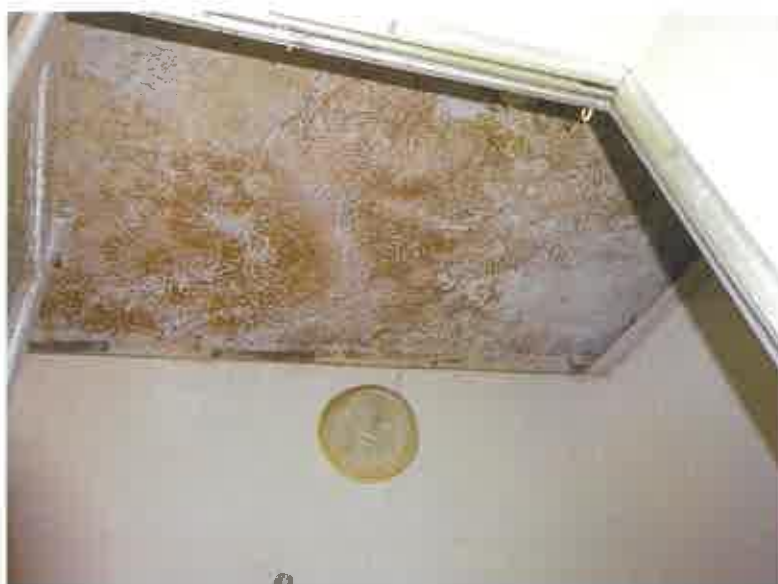
浴室天井パネルなし
