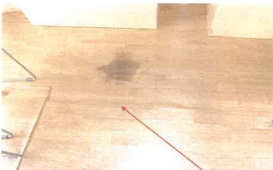
1階床上げ部分の床の状態(ひび割れている)
