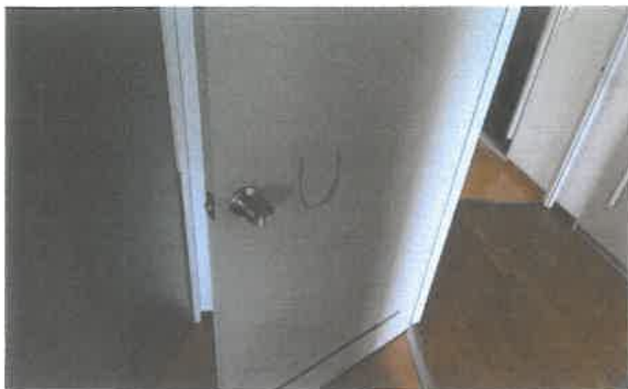
北東側洋室のドアの損傷
