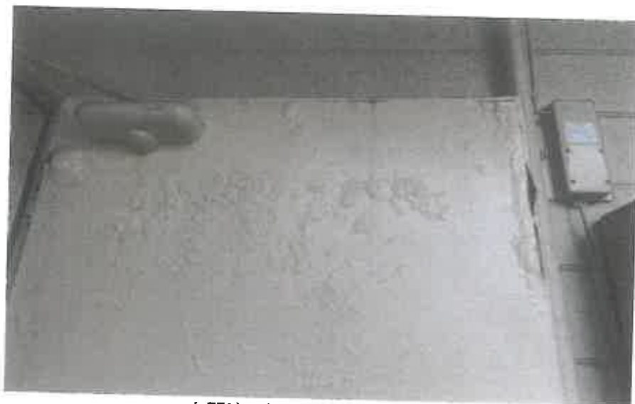
玄関ドア内側の腐食
