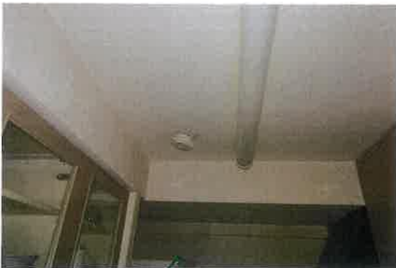
報知器配線の切断
