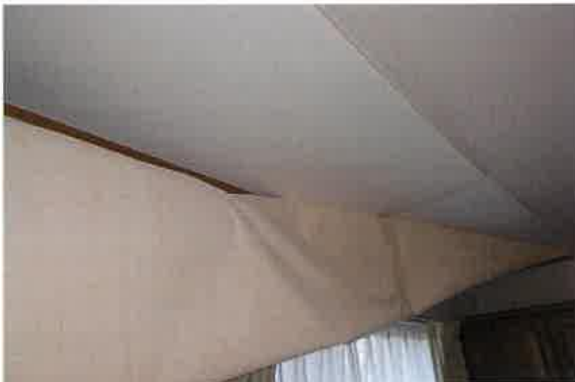
2階洋室1の天井クロスの剥がれ
