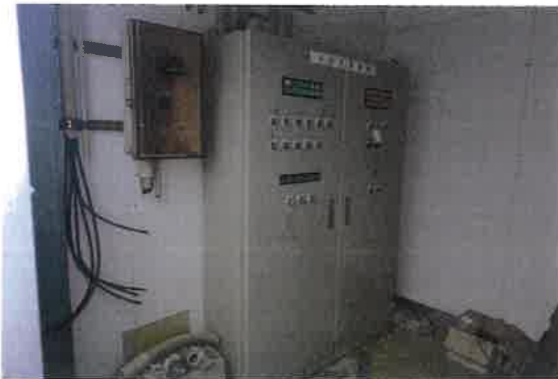
物件4電気室(電気配線切断)
