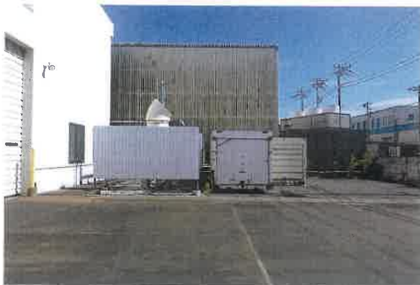
冷却塔とコンテナ
