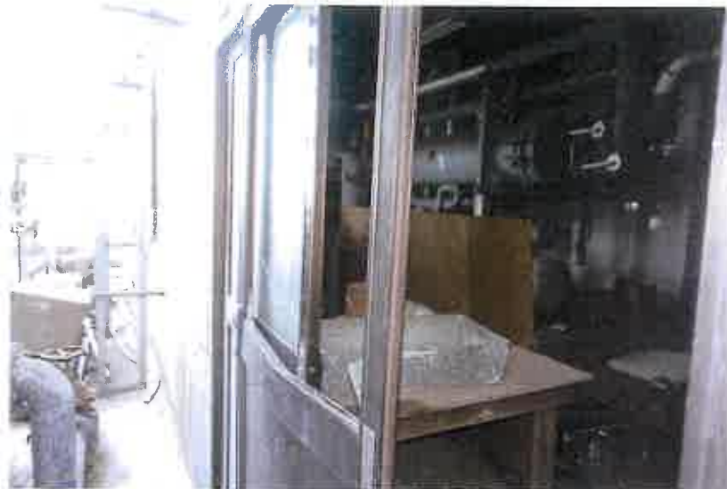
機械室入口のドア破壊
