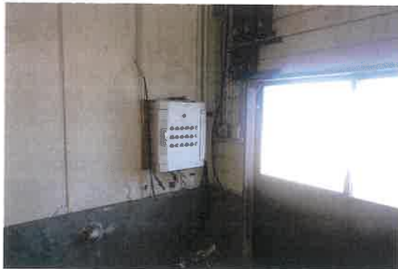
電気配線切断
