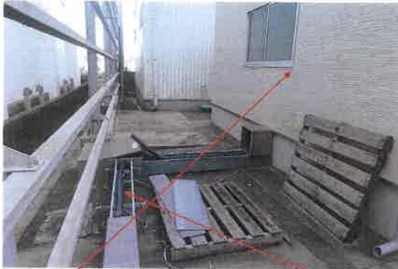
「未登記附属建物電気室」から主たる建物への電気配線が無い
