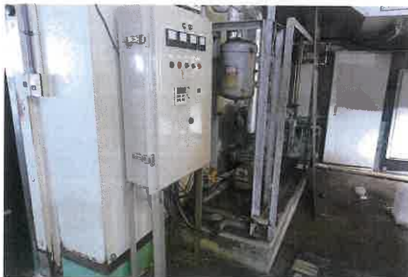
乾燥機の電気配線切断
