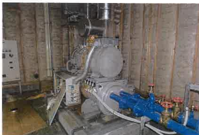
冷蔵冷凍機械室内部のコンデンシングユニット
