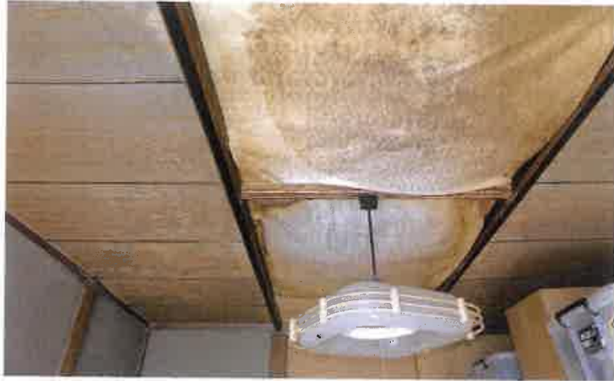
2階南東側和室の雨漏れ
