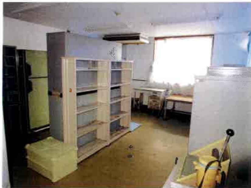
天井、内壁のクロスの剥がれ
