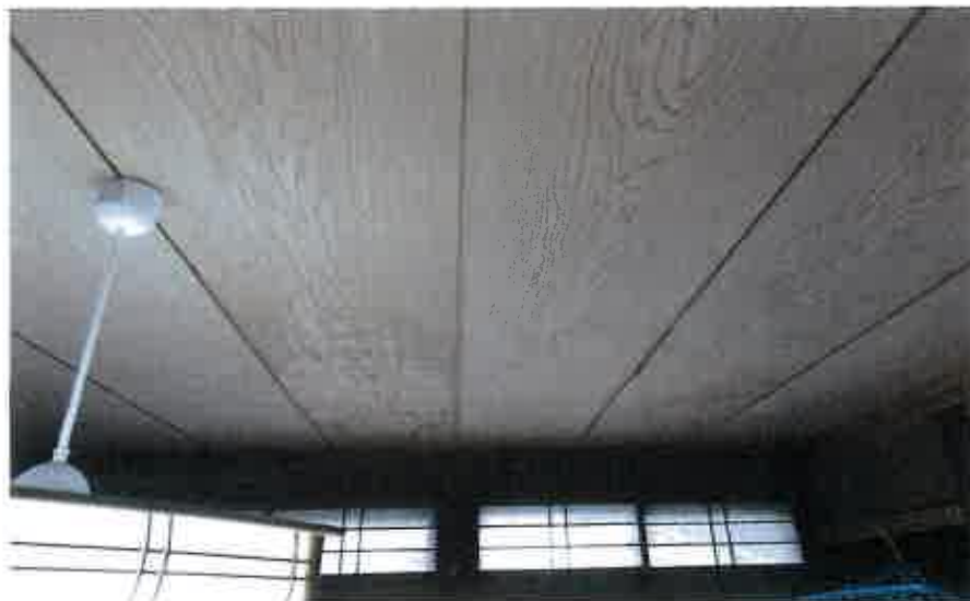
1階和室天井の雨染み
