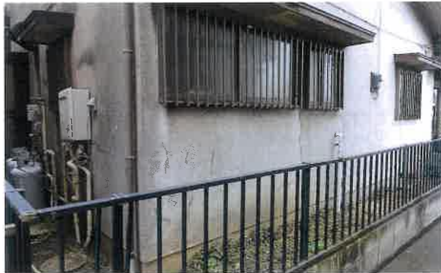
外壁のクラック
