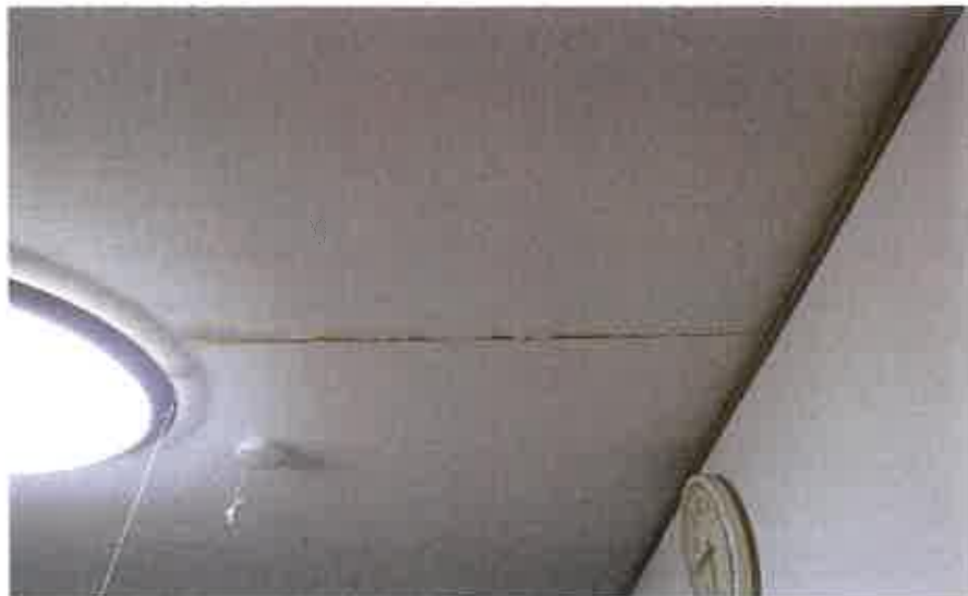
洋室Dの天井クロスのひび割れ
