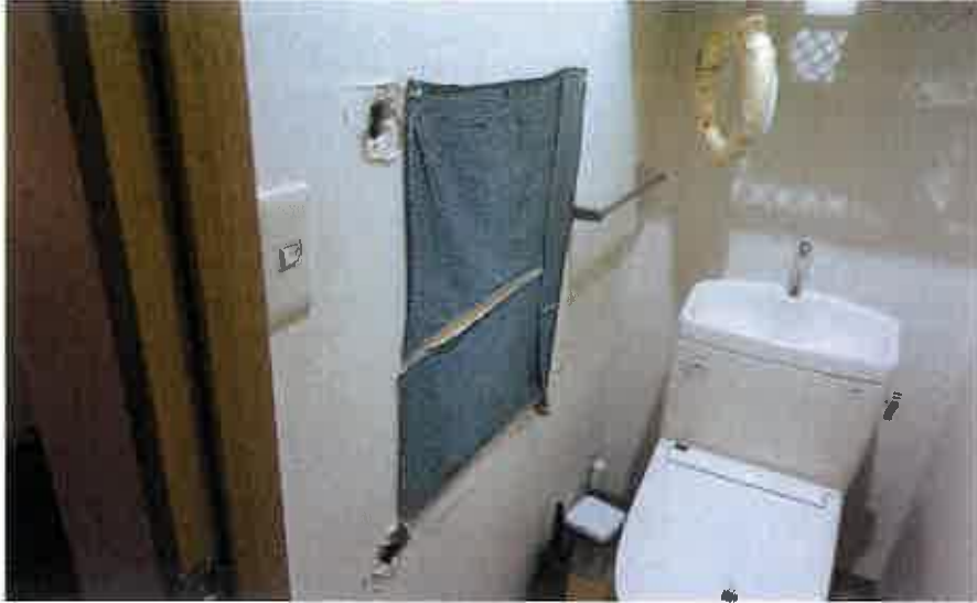
1階トイレ壁の穴
