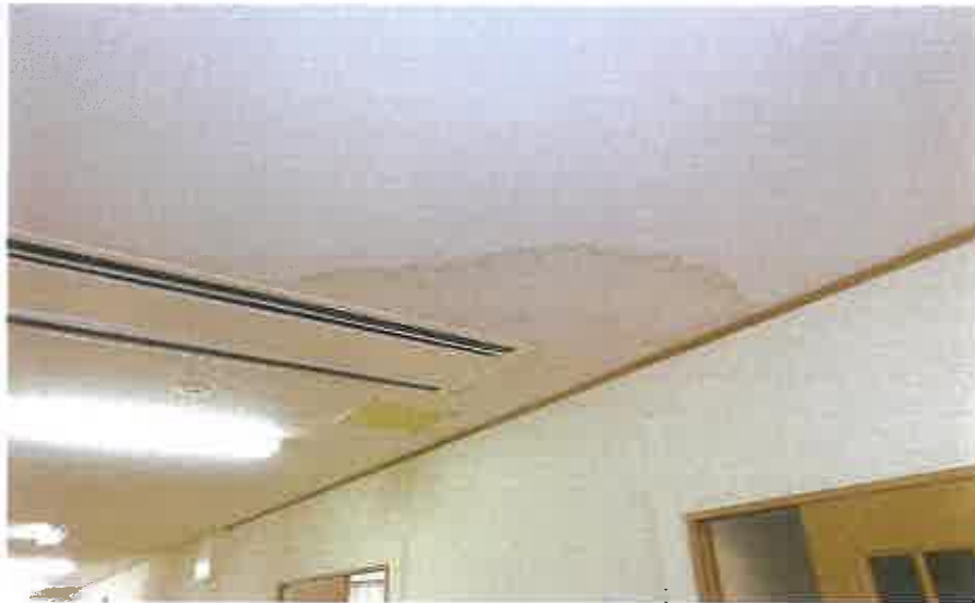
1階廊下天井の染み
