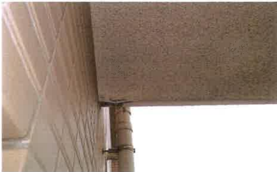
上階バルコニー下部の破損
