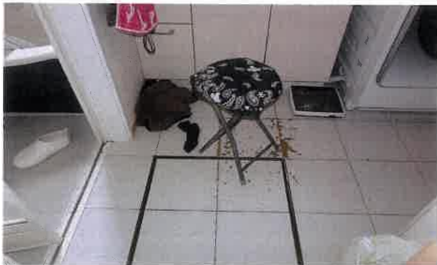
洗面室床の剥がれ
