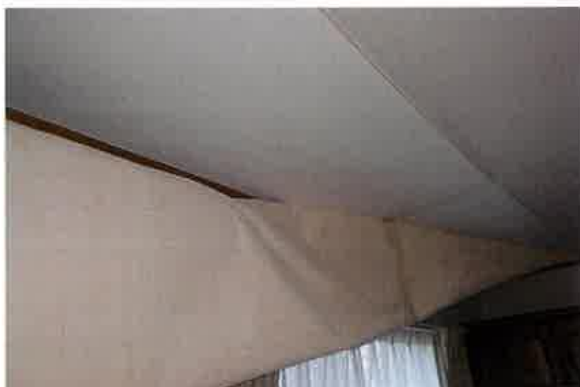
2階洋室1の天井クロスの剥がれ
