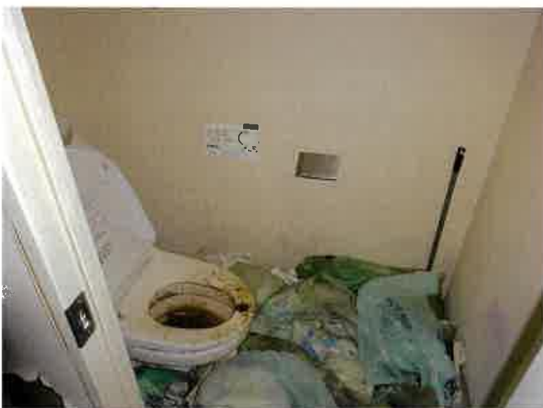
トイレの汚れ 使用不可の可能性あり
