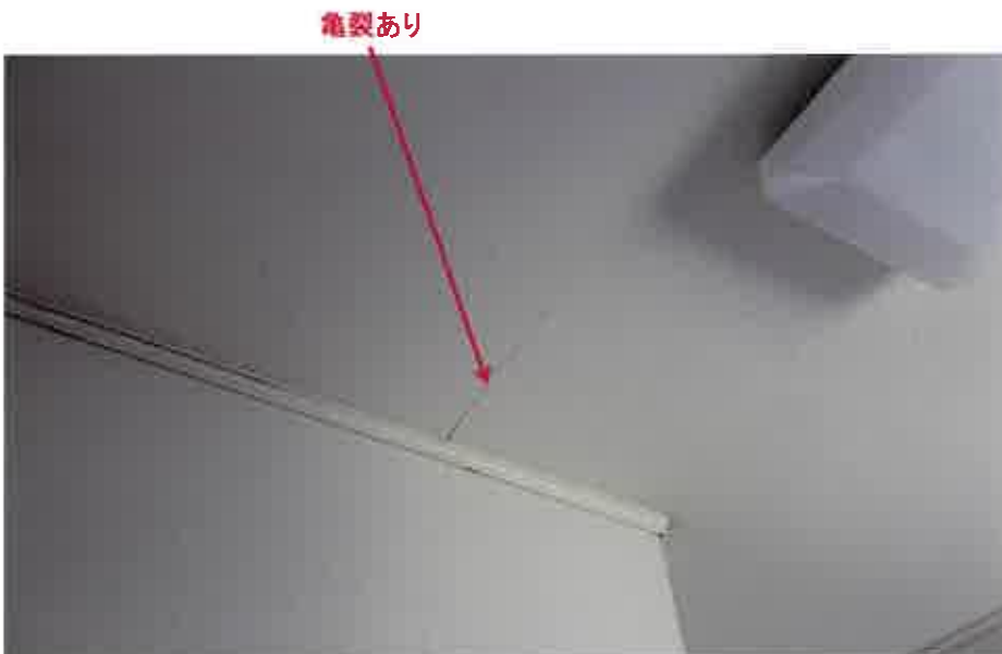
6 (物件2 2階廊下の天井)
