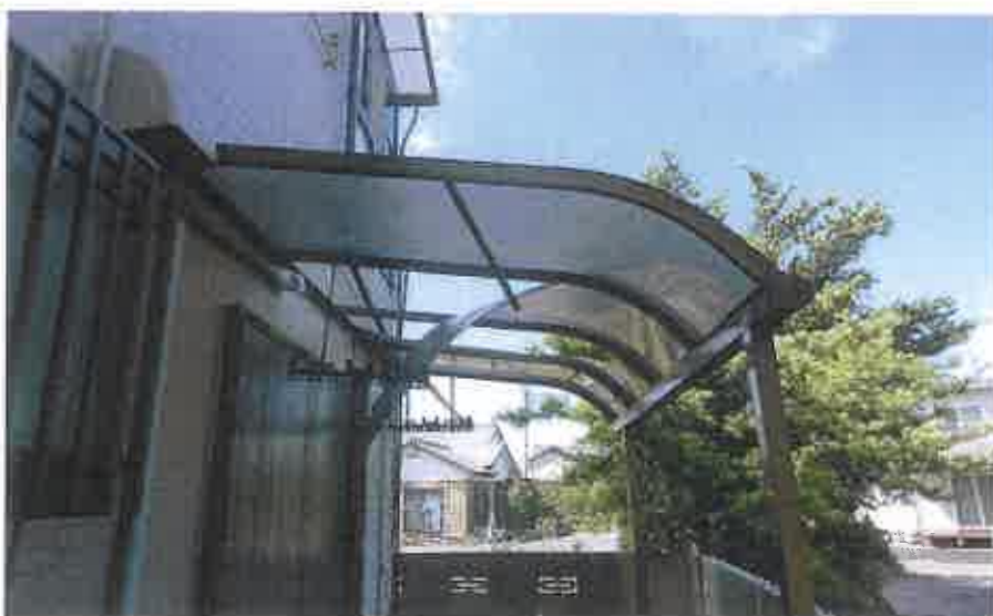
東側樹脂製の底の破損
