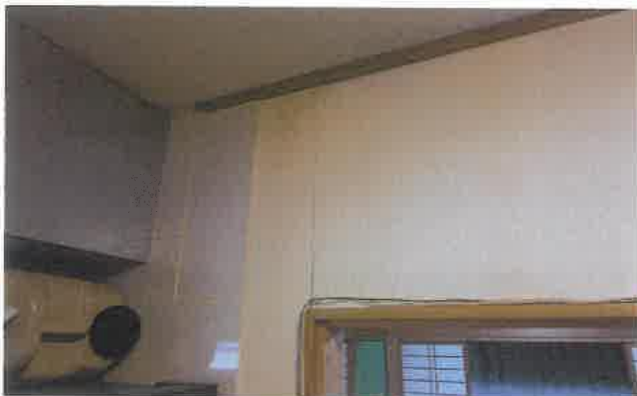
1階キッチン壁のひび割れ
