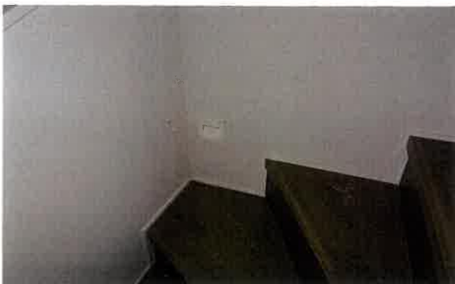
1階階段及び壁の損傷
