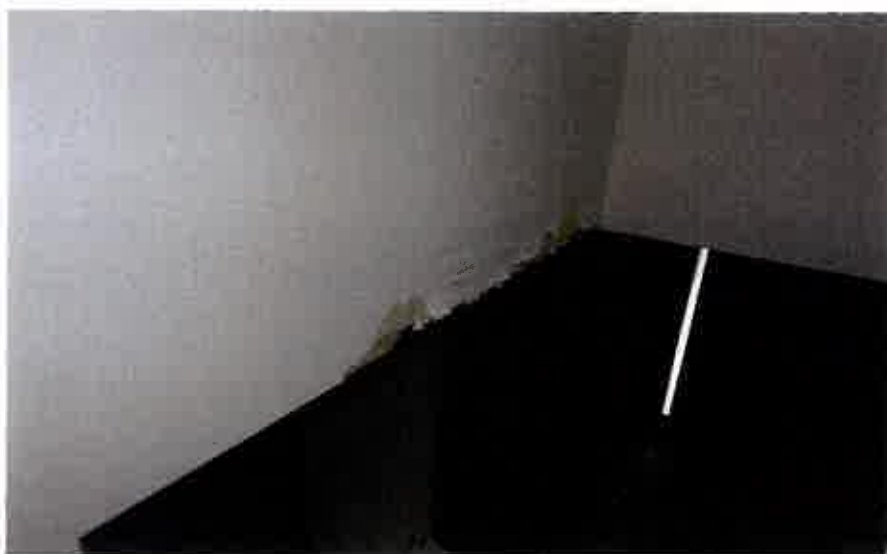
1階階段天井部の損傷
