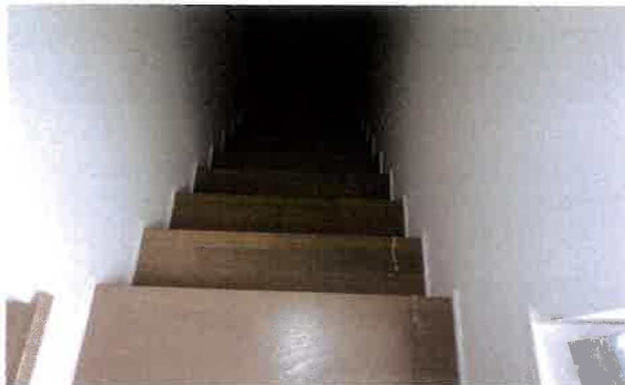
階段の引き摺り損傷
