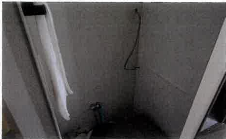
1階洗面が設置されるべき場所
