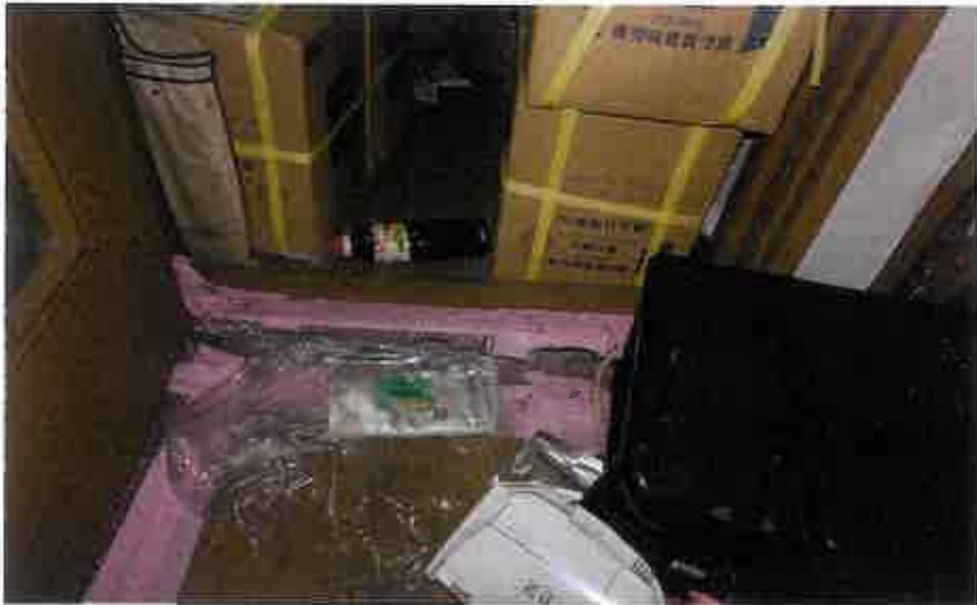
1階リビング床面の沈み
