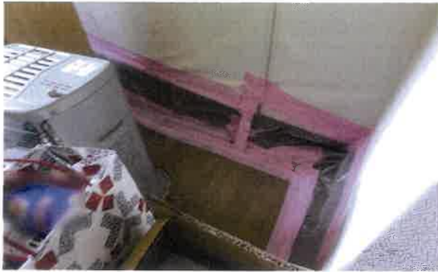
1階キッチン床面の沈み
