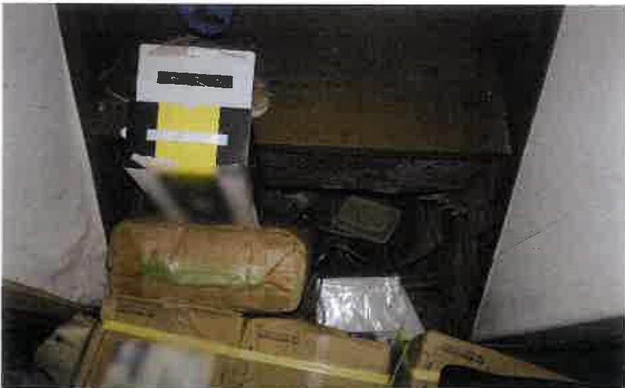
1階階段1段目の踏み面損傷
