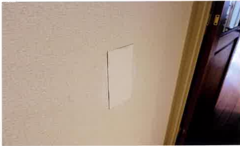
8 (物件1 壁の配線修理跡)
