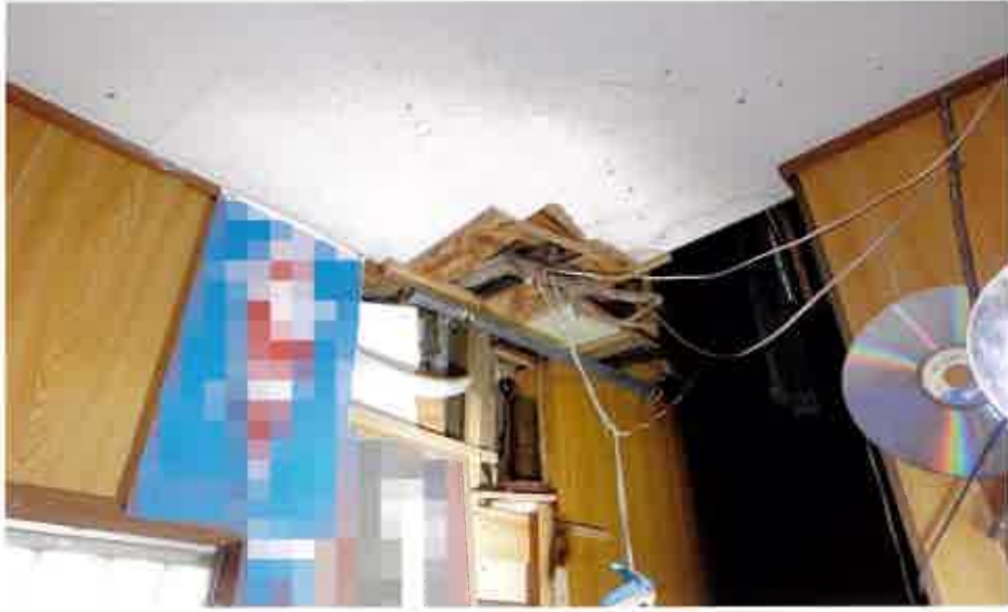
16 (物件 4 1 階階段付近の天井)
