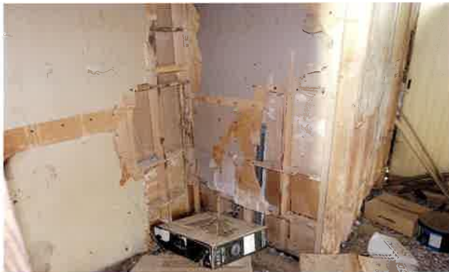
14 (物件 4 1階和室(1)の壁)
