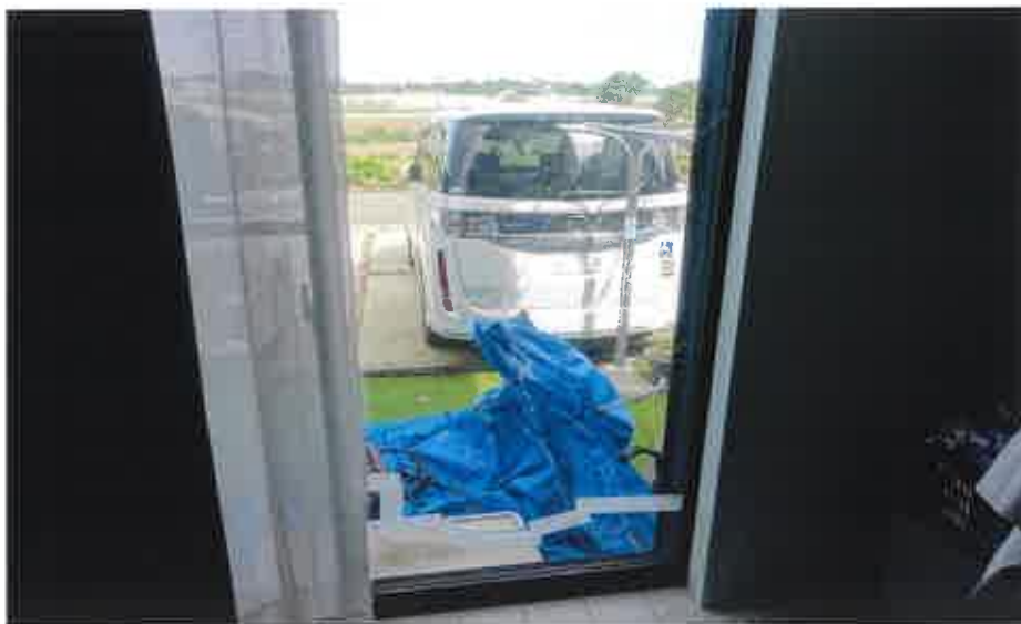
7 （物件2 の1階 窓ガラスの ひび割れ）
