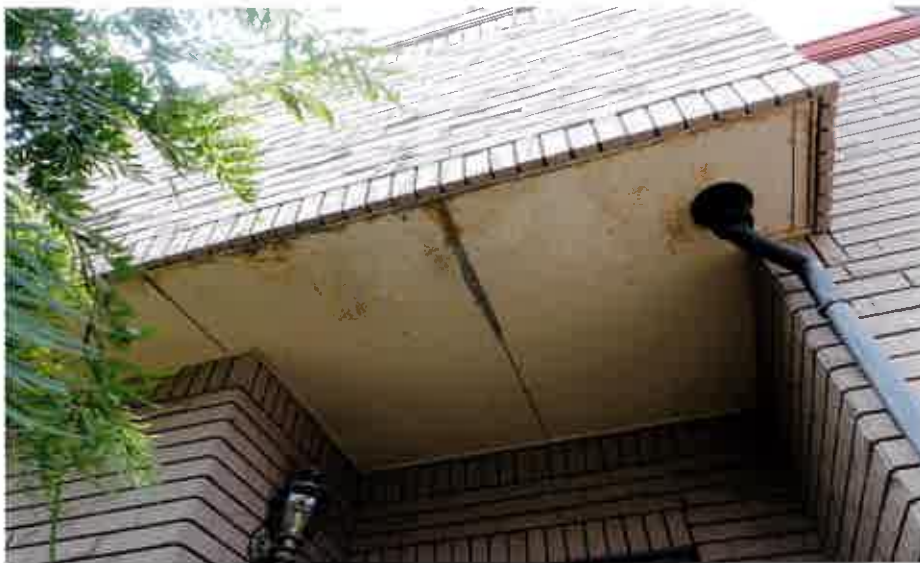
※雨漏り補修済みとのこと
