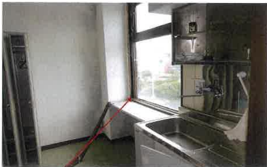
窓枠の腐食 給湯室
