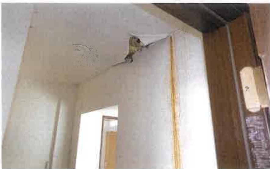
トイレ前の天井損傷
