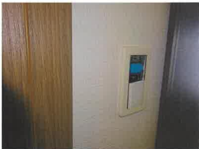
電灯スイッチの破損
