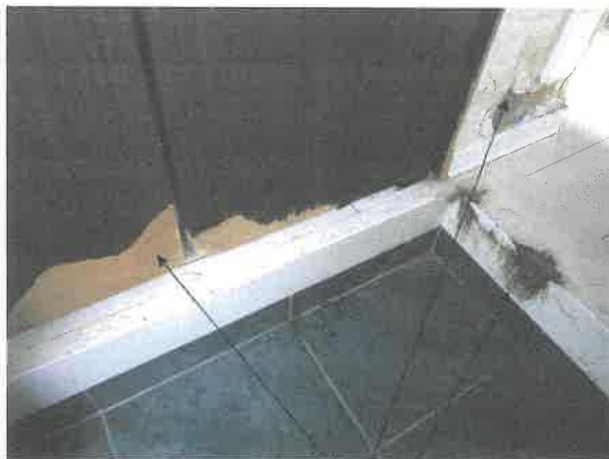
玄関内の破損状況
