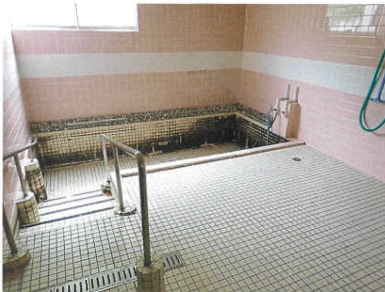
附属建物 2（更衣室の天井材の黒ずみ・剥がれ） ㊹
