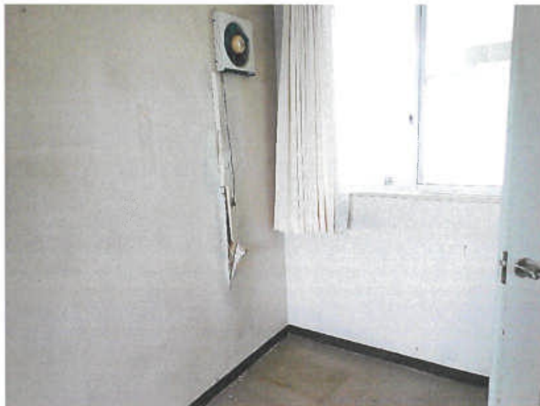
主たる建物（3階病室の壁穴・破れ）㊺
