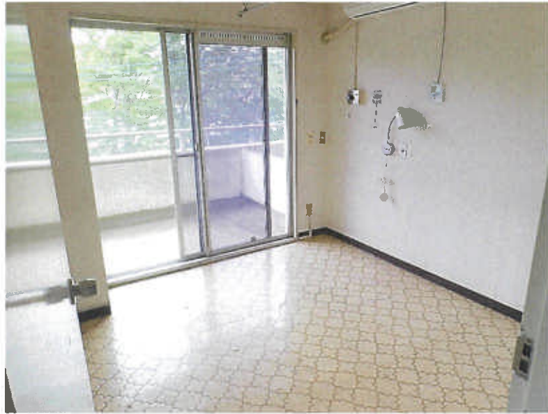
主たる建物（3階病室の壁の崩れ）㊹
