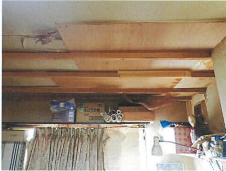
302号室（雨漏り部分）㉖
