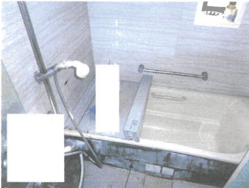
カビが発生している
