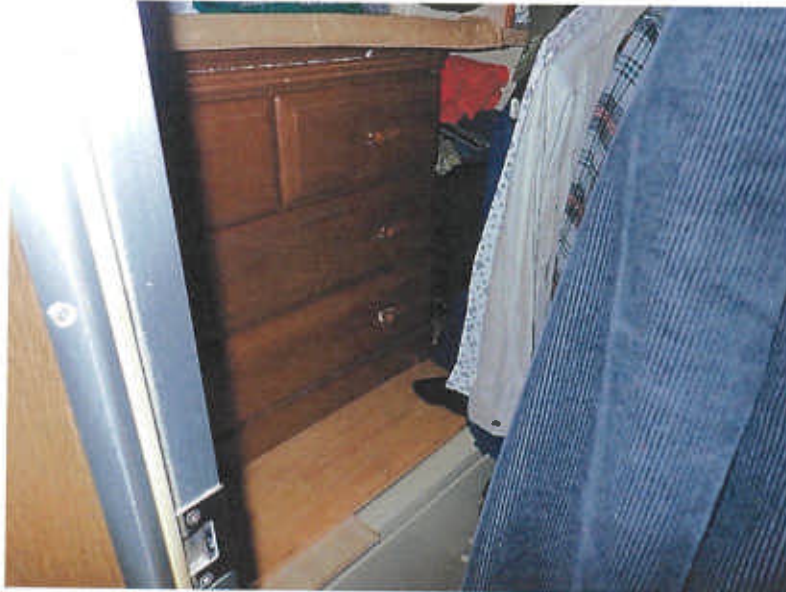
103号室 (床材の腐食) ⑭
