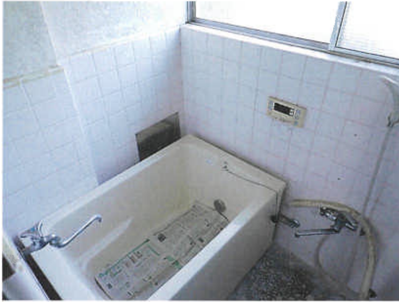
201号室 (雨漏り箇所) ⑪
