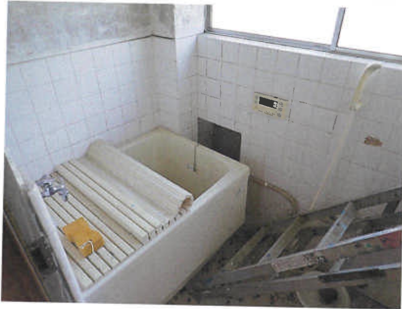
203号室（雨漏り跡）㉔
