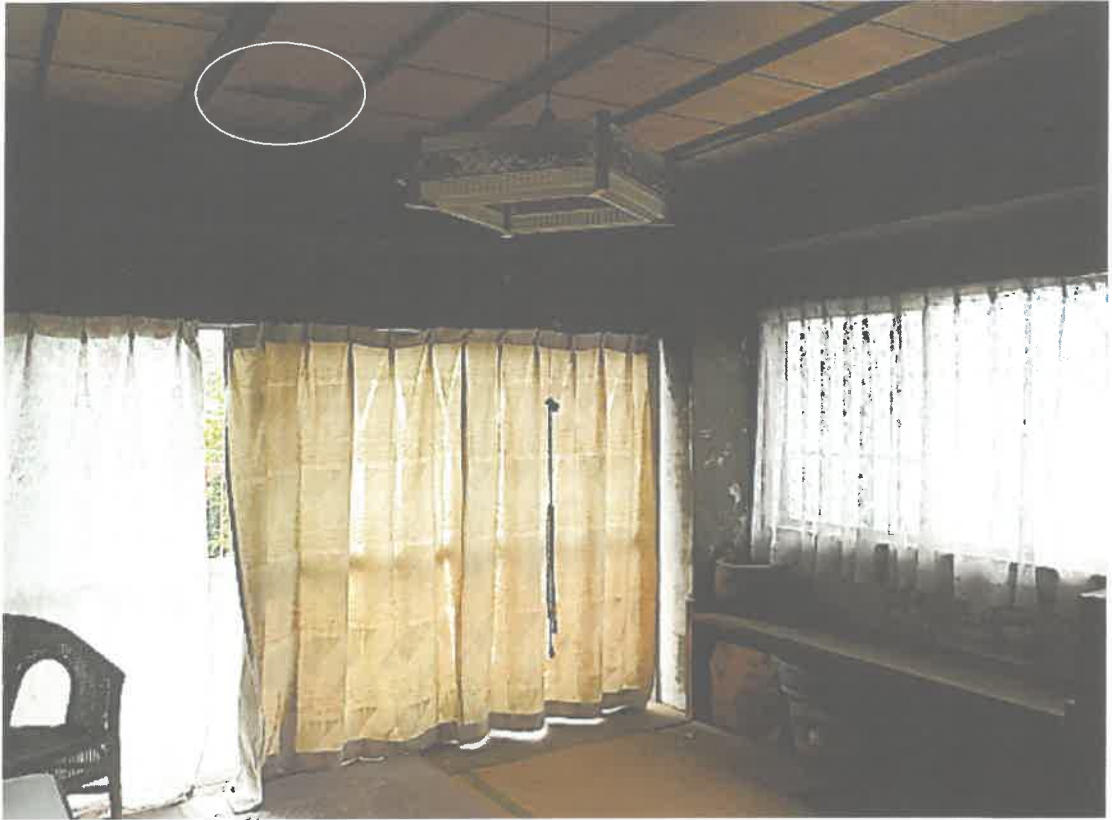
円内は雨漏り痕が推定されるシミ
