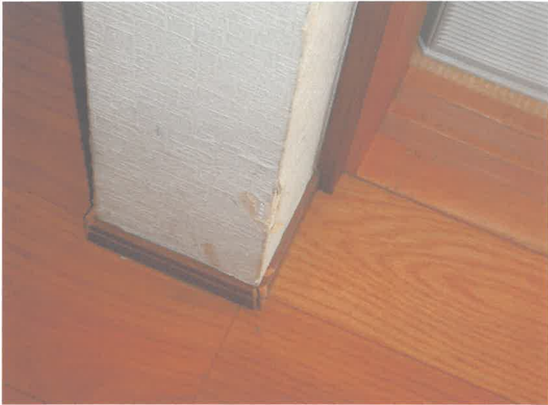
⑤ 壁紙等の 損傷
