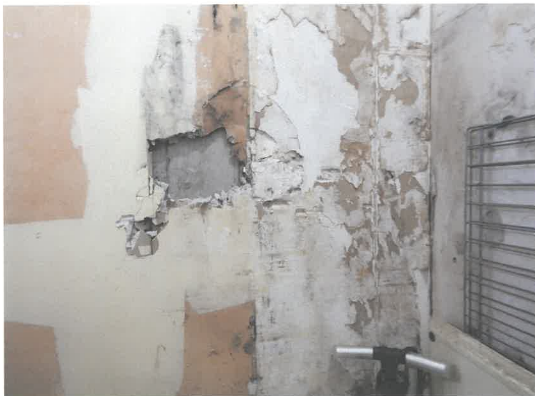
No.020 壁の損傷
