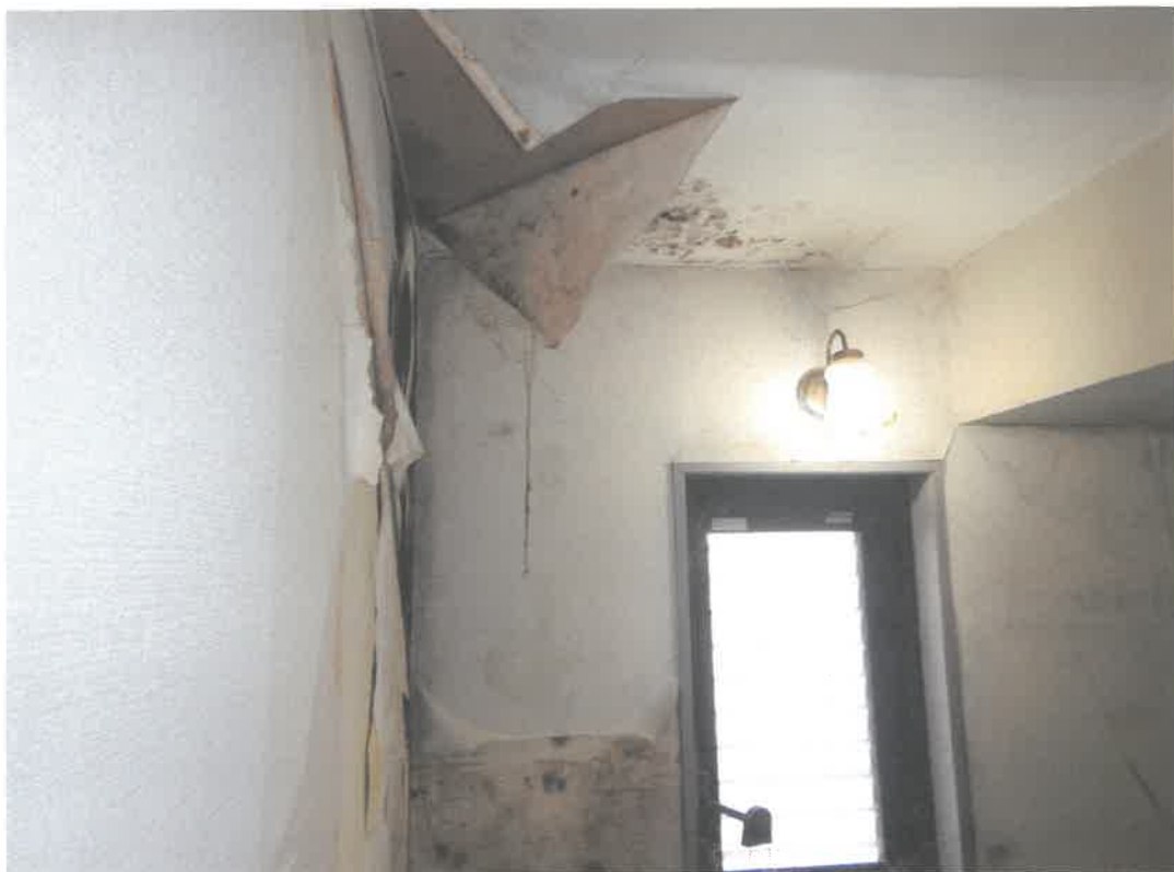
No.019 壁紙の損傷
