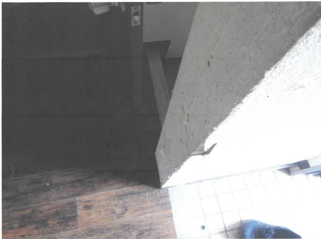
No.025 壁紙の損傷
