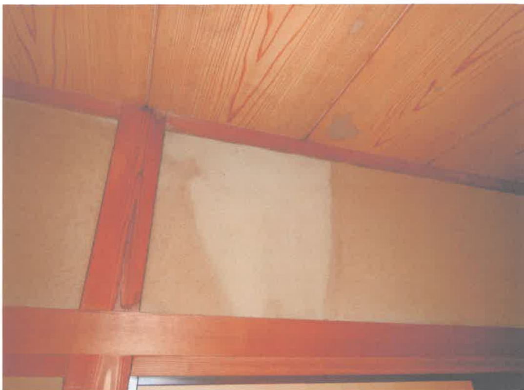
⑪ 雨漏り跡
