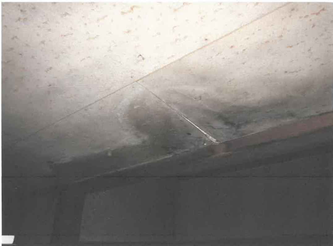
②0 雨漏り跡
