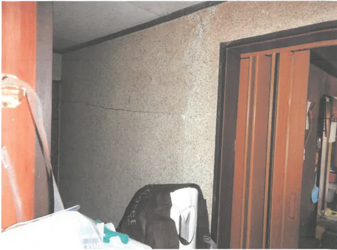
①9 壁の亀裂
