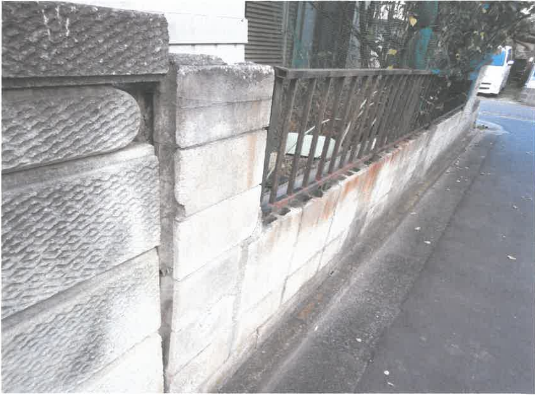
③ 塀の傾き
