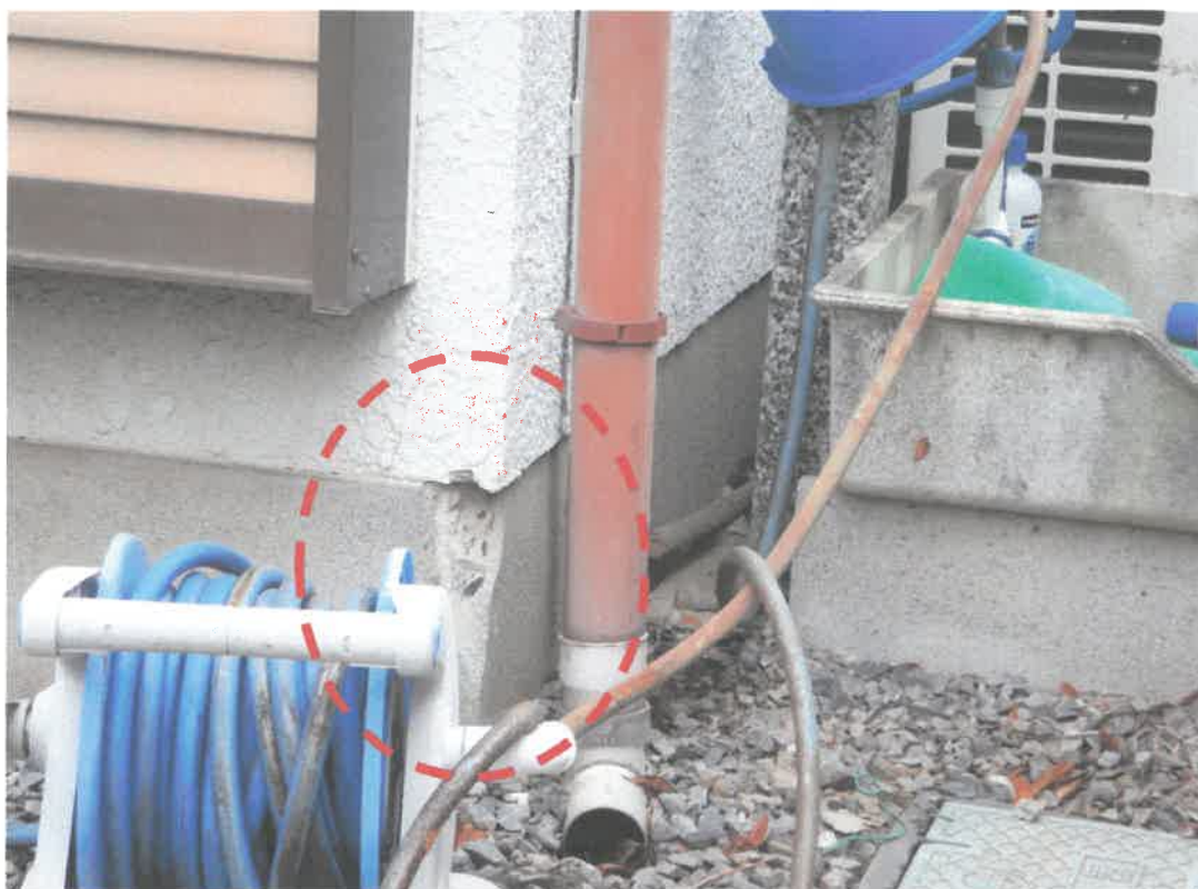
③ 基礎部分の 欠け
