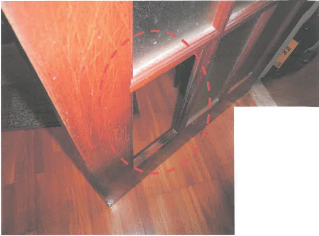
⑦ ドアガラス の欠損
