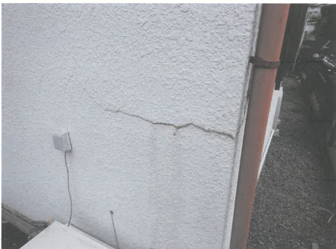
④ 外壁亀裂
