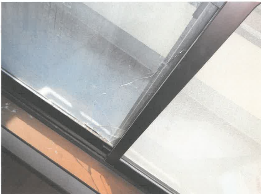
⑨ ガラスの 損傷
